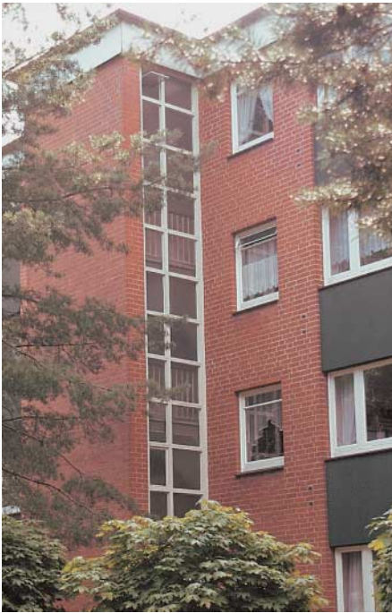
Das Dachgeschoss dieses typischen hanseatischen Klinkerbaus zeigt vor allem in den Räumen der obersten Etage ausgedehnten Schimmelwuchs
