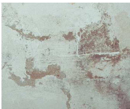
Die Auswirkungen von schimmelfreundlichen Bedingungen. Trotz Reinigung sind die Spuren noch deutlich sichtbar
