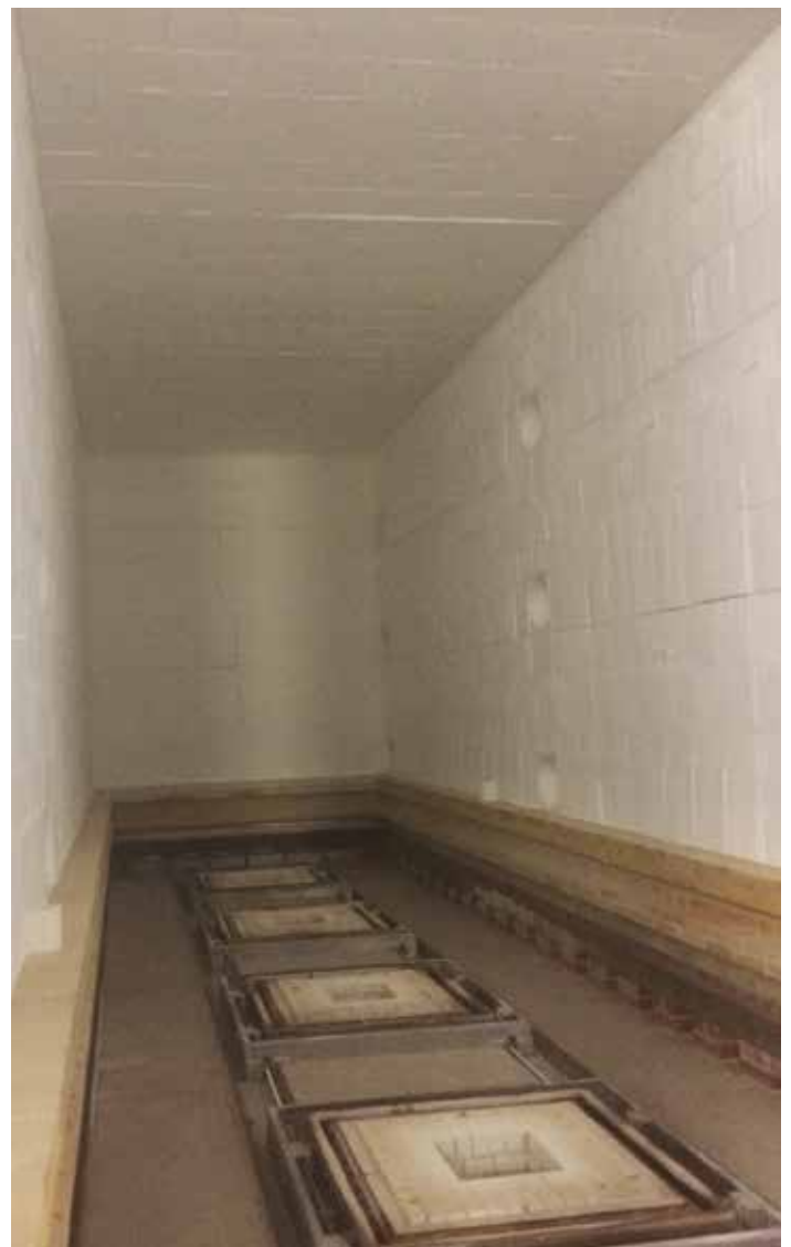
Herdwagenofen Porzellanfabrik nach Inbetriebnahme
